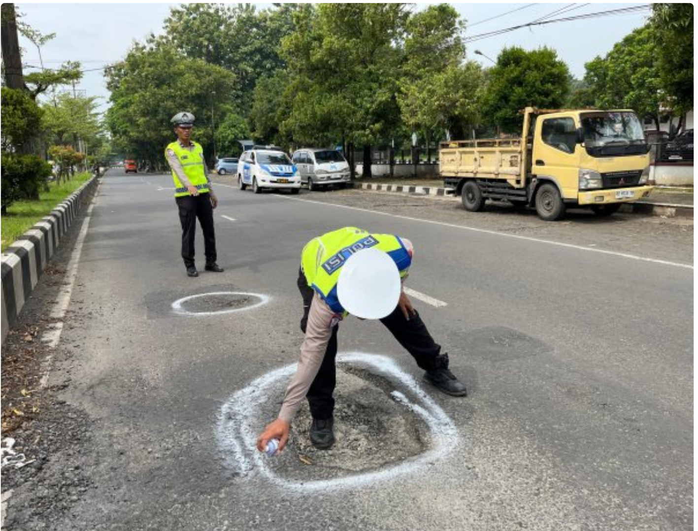
Survei Jalur Mudik Lebaran, Polres Purbalingga, Temukan Jalan Berlubang dan Lampu Jalan Mati
